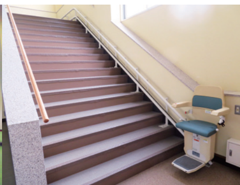
プール棟内 昇降機
