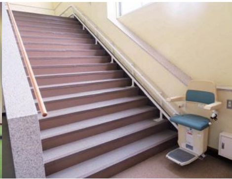
プール棟内 昇降機
