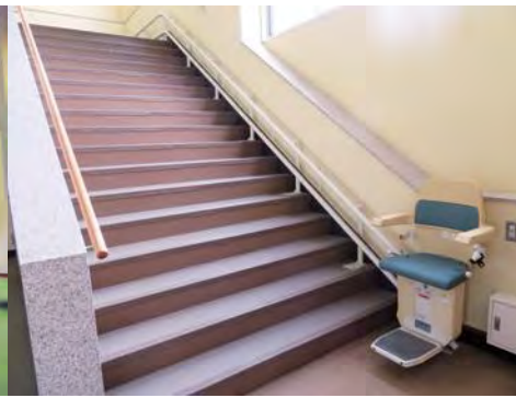
プール棟内 昇降機
