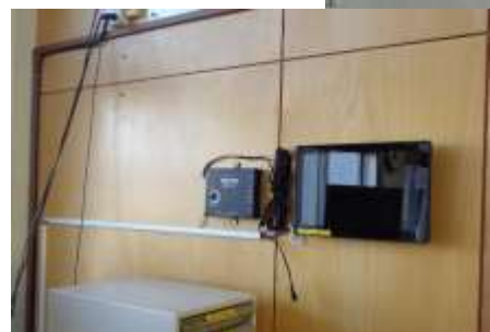
職員室に新しく設置された緊急地震速報装置
